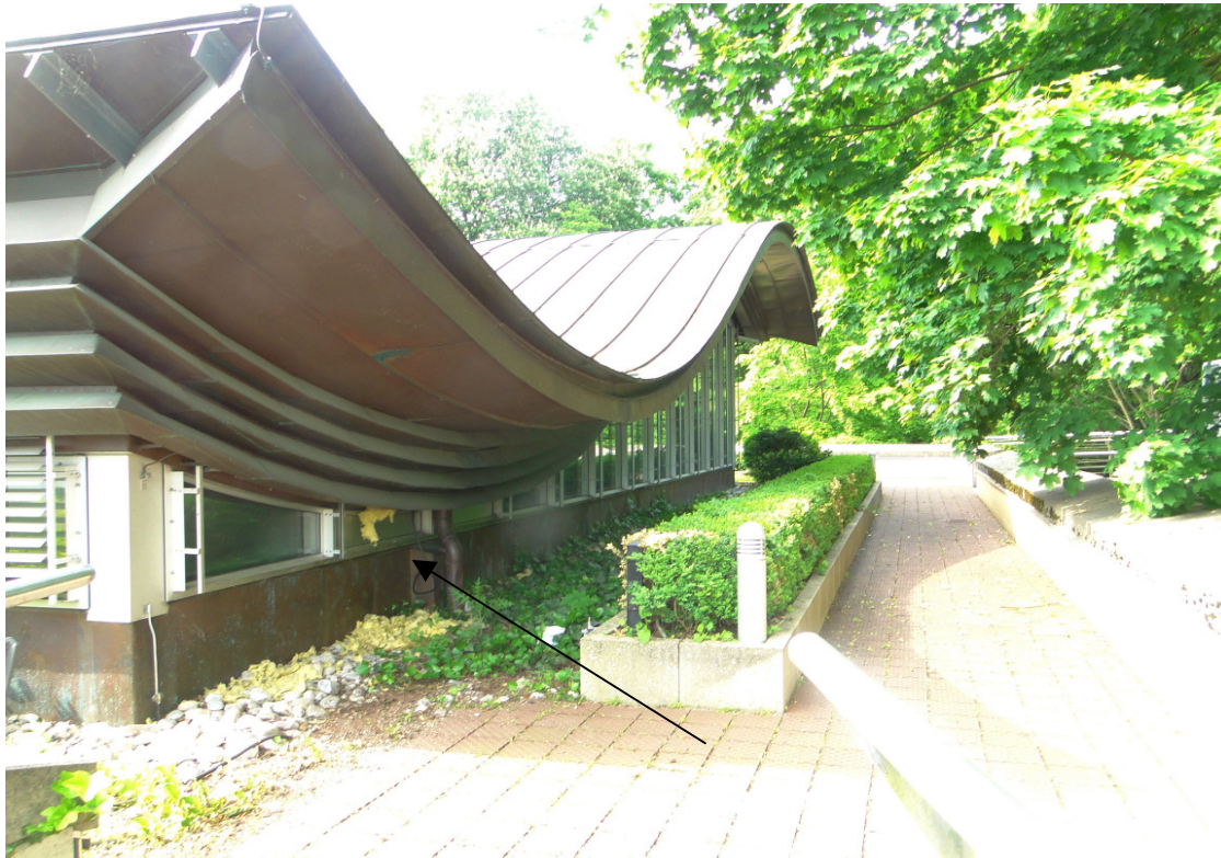
Marderschaden an der Dachdämmung
