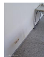
Feuchteck am Sockel?
