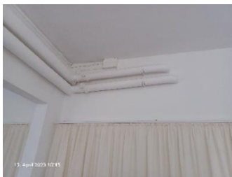
Hauptleitung aus der Heizung
